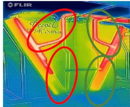
Fig. 3 Chiller raffreddato ad aria con accumulo di refrigerante nel condensatore e conseguente diminuzione delle prestazioni
